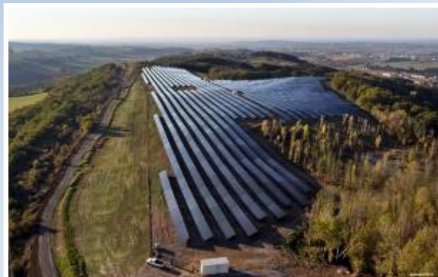
Centrale Solaire du SEQUESTRE Département du Tarn (81) Puissance électrique : 4 500 KWc Mise en service : Octobre 2013
